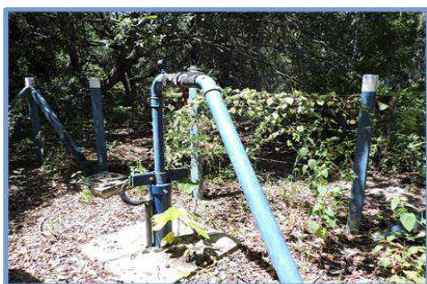
Figura 3-3 – Poço artesiano – Água dos Paulista Fonte: COBRAPE (2021)
