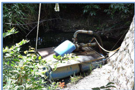
Figura 3-5 – Captação superficial na nascente Água dos Paulista Fonte: COBRAPE (2021)
