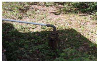
Figura 51 – Poço Artesiano - Comunidade Barreira de São João
