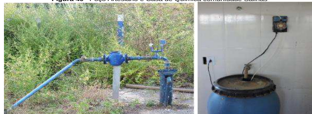
Figura 40 – Poço Artesiano e Casa de Química comunidade Salinas
