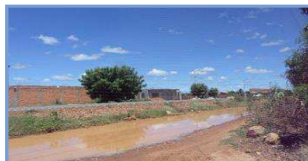
Figura 3-41 – Acúmulo de águas pluviais devido à insuficiência dos sistemas de drenagem
