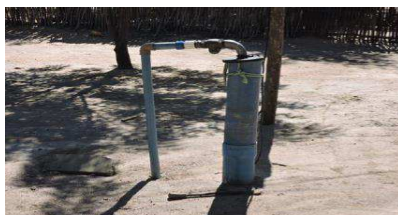
Figura 47 – Poço Artesiano - Comunidade Baraunas
