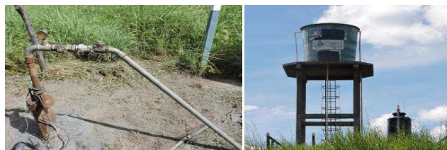
Figura 56 – Poço Artesiano e Reservatório- Comunidade Olhos d'água Paulista
