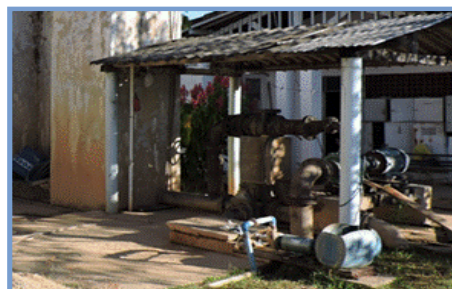
Figura 3-19 – Ponto de abastecimento de caminhão pipa na ETA Sede
