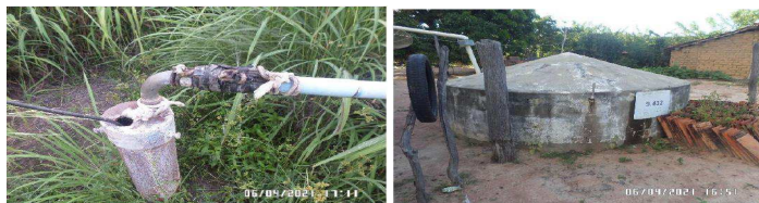
Figura 69 – Poço Artesiano e Cisterna- Comunidade Calumbi
