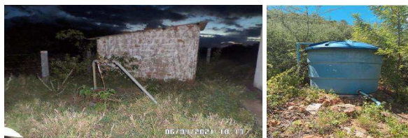
Figura 63 – Poço Artesiano e Reservatório- Comunidade Garapa
