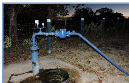
Figura 3-14 – Poço artesiano – Comunidade Macambira
