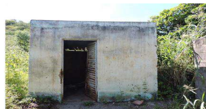
Figura 48 – Casa de Controle - Comunidade Barreiro do Rosa
