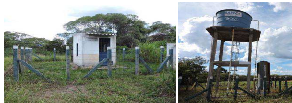
Figura 52 – Poço Artesiano e Reservatório- Comunidade Xixá
