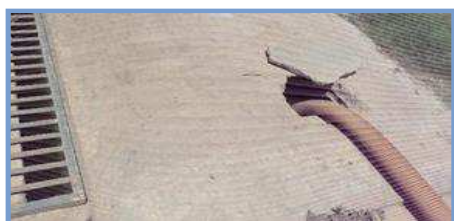
Figura 3-43 – Reservatório para captação das águas pluviais na Praça Elmir de Souza
