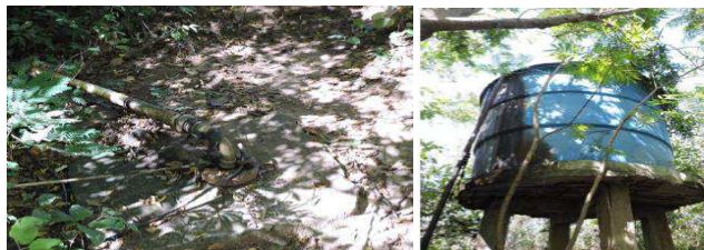
Figura 46 – Poço Artesiano e Reservatório- Comunidade Agreste
