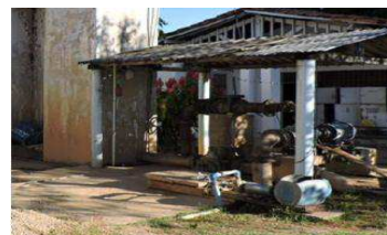
Figura 45 – Ponto de Abastecimento de Caminhão Pipa da ETA Sede
