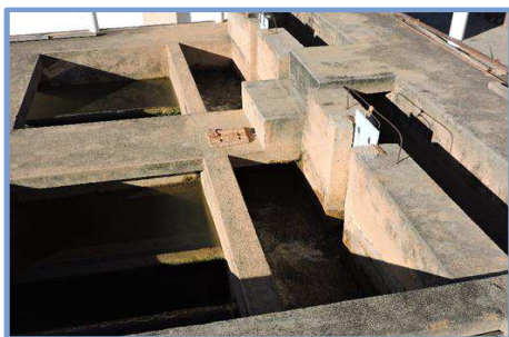
Figura 3-7 – Filtros da ETA Sede Fonte: COBRAPE (2021)
