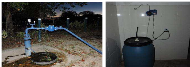
Figura 39 – Poço Artesiano e Sistema de Cloração comunidade Macambira
