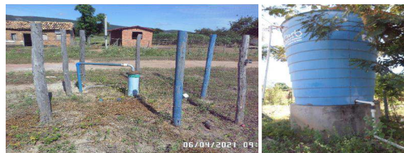
Figura 65 – Poço Artesiano e Reservatório- Comunidade Caibros
