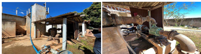
Figura 25 – Estações Pressurizadoras da SEDE e Caatingas
