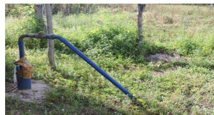
Figura 54 – Poço Artesiano - Comunidade Conceição
