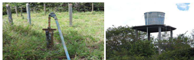
Figura 50 – Poço Artesiano e Reservatório- Comunidade Pedra Cumprida I
