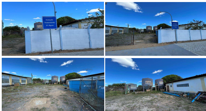
Figura 28 – ETA 1 – Estação de Tratamento da Água – ETA Caatingas
