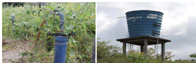
Figura 49 – Poço Artesiano e Reservatório- Comunidade Macambira do Agreste
