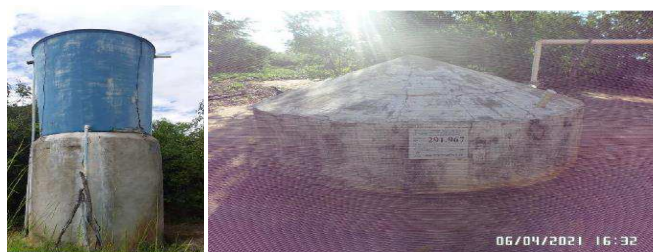
Figura 68 – Reservatório e Cisterna- Comunidade de Varzea
