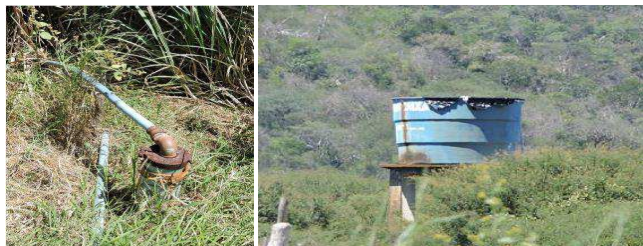
Figura 55 – Poço Artesiano e Reservatório- Comunidade Moreira
