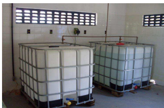
Foto 17 – Sistema de Preparo e Aplicação das Soluções Químicas
