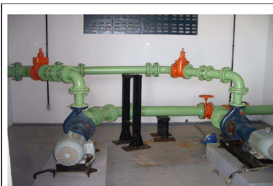
Foto 22 – CMB EEAT Lavagem de Filtros
