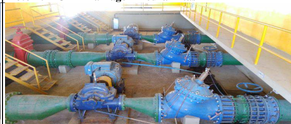
Foto 12 – Conjuntos motor bombas EEAB II
