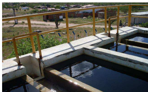
Foto 20 – Unidade de Filtração Direta Ascendente
