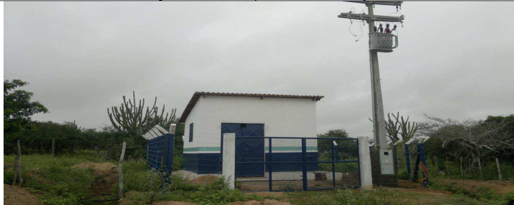
Foto 13 – EEAB Booster para SIAA Pé de Serra
