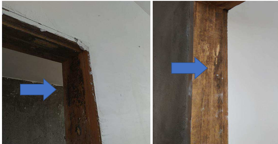
Apontamento 1: Marcas de fungos nas aduelas.
