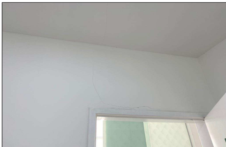
Fissuras nas paredes
