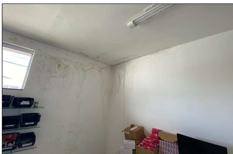
Infiltrações no forro de gesso e paredes
