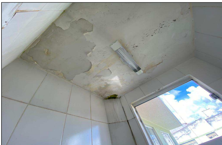
Infiltrações no forro de gesso e paredes
