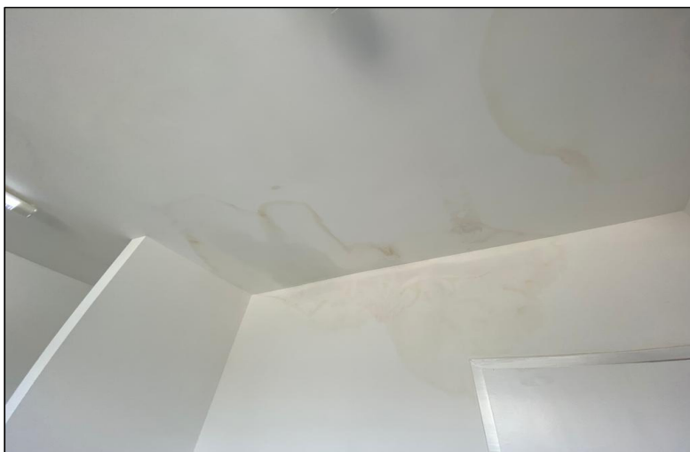
Infiltrações no forro de gesso e paredes
