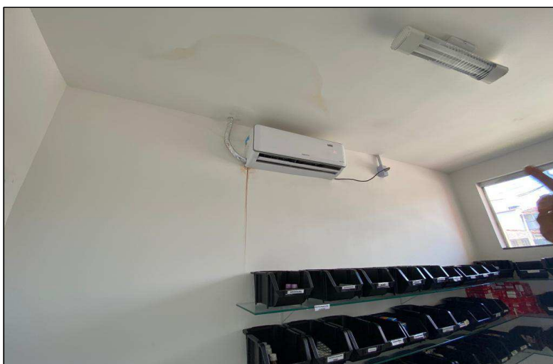
Infiltrações no forro de gesso e paredes
