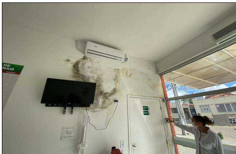
Infiltrações no forro de gesso e paredes
