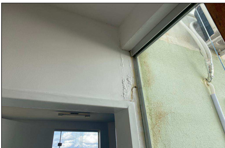
Infiltrações nas paredes internas
