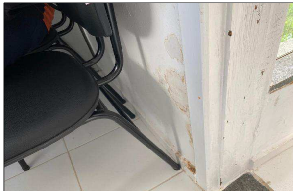
Infiltrações nas paredes internas
