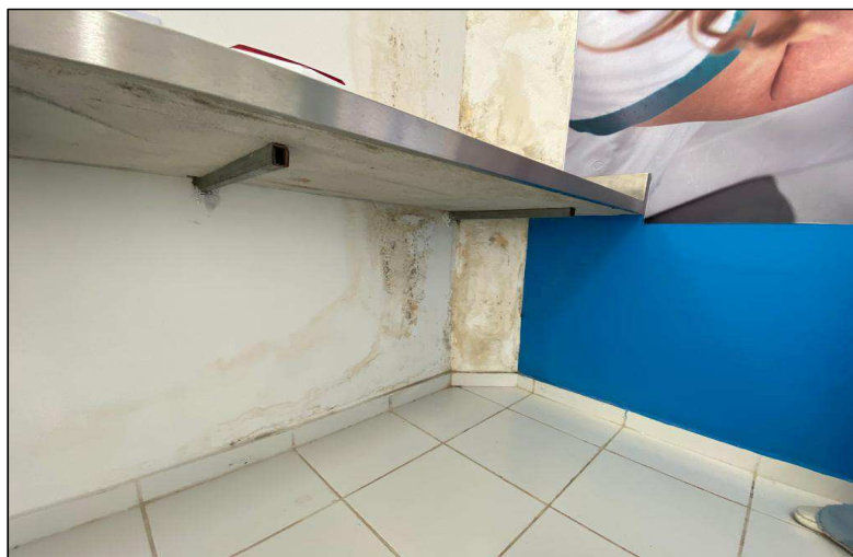
Infiltrações no forro de gesso e paredes
